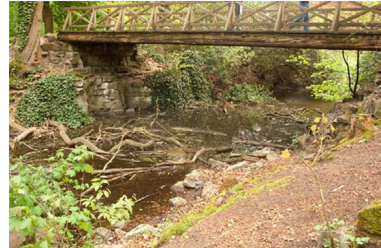
Herstel van de brug en uitbageren van de vijver is dringend nodig.
